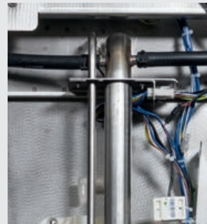
Steigleitungen aus Edelstahl
